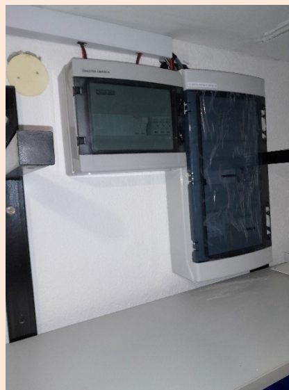
Slika 5: AC in DC priključna omarica
